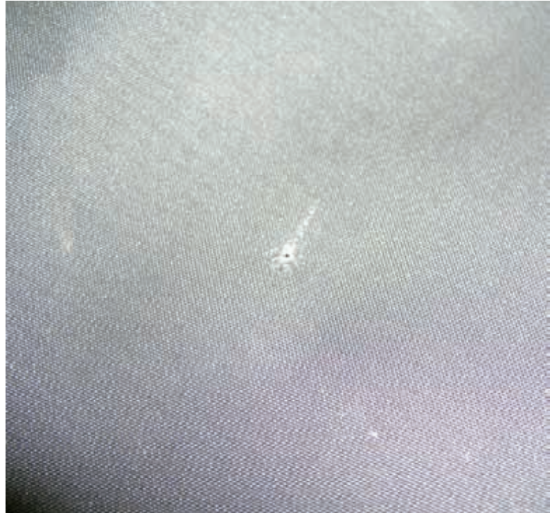
Riss im Stützgerüst durch äußere, mechanische Einwirkung
